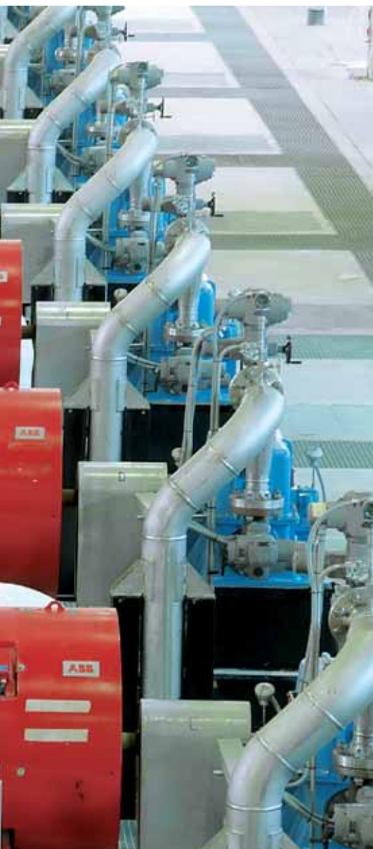
Planta desaladora de Torrevieja. Alicante. España.
